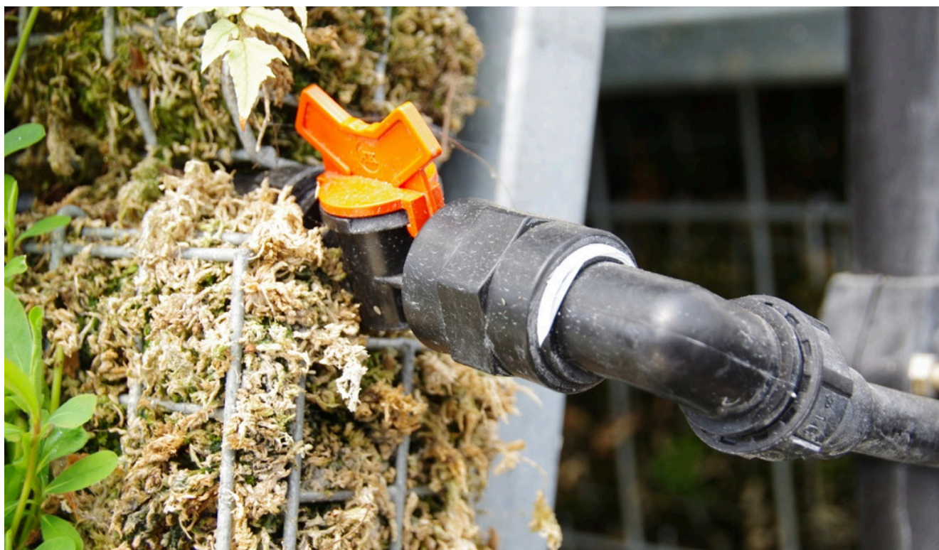
Abb. 81: Bewässerungsleitung wandgebundene Begrünung (Foto: Nicole Pfoser)
