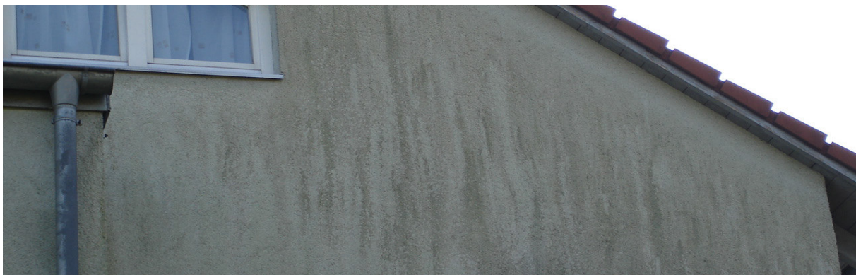
Algen und Pilze an einer Hausfassade
