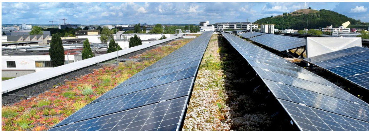
Abb. 2: Photovoltaik-Anlage auf begrüntem Dach
