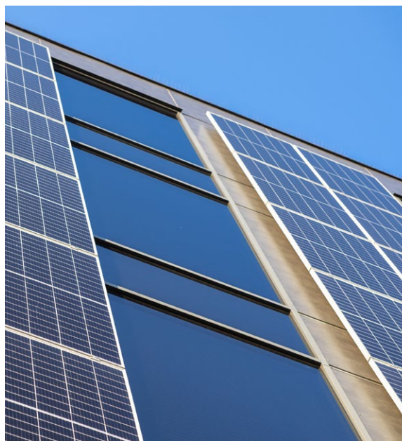
Abb. 3: Photovoltaikanlage an der Fassade
