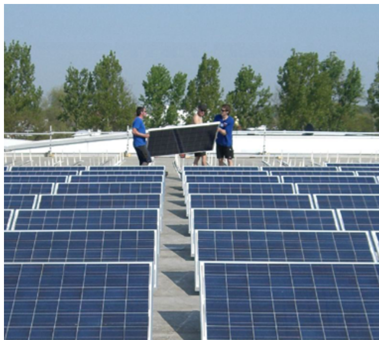
Abb.: PV-Anlage beim Freiburger Tofu-Hersteller Taifun (Bild:Taifun)
