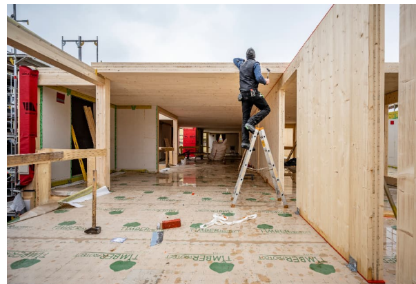
Serieller Holzbau in der Aufrichtungsphase Freiburg-Schildacker
