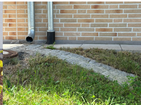
Dachentwässerung über Muldenrinnen
