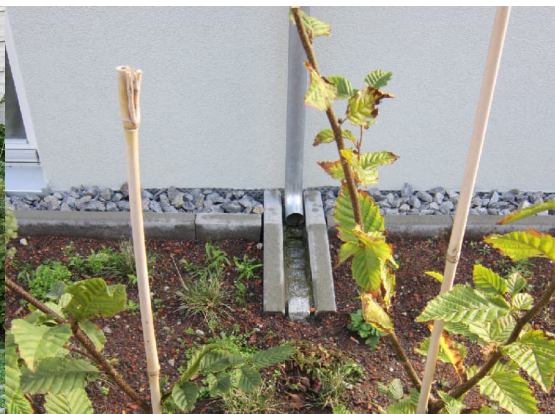
Dachentwässerung über Randsteine
