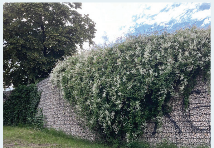
Lämschutzwand Mittlerer Ring, München
