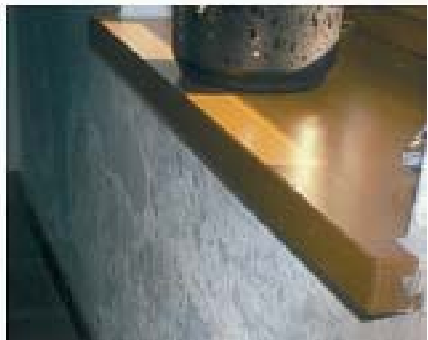
Feuchteschäden an HWL-Platten
