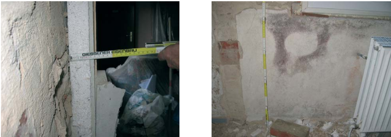
Abb. 12: Geöffnete Innendämmung mit EPS- Verbundplatten (links). Schimmelbildung durch Hinterströmung an undichtem Fensterbankanschluss (rechts). Foto: Wilfried Walther, Springe
