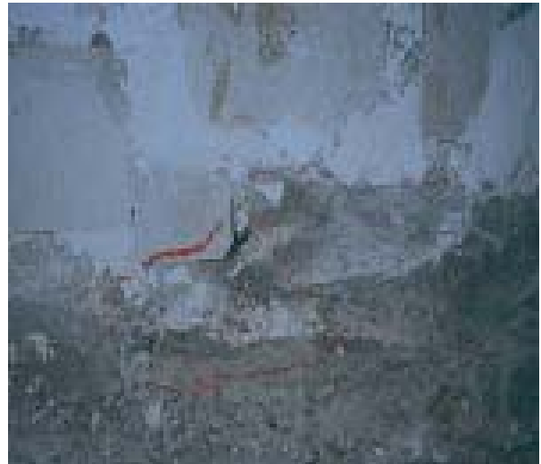
Wasserdurchtritt (rote Linie)
