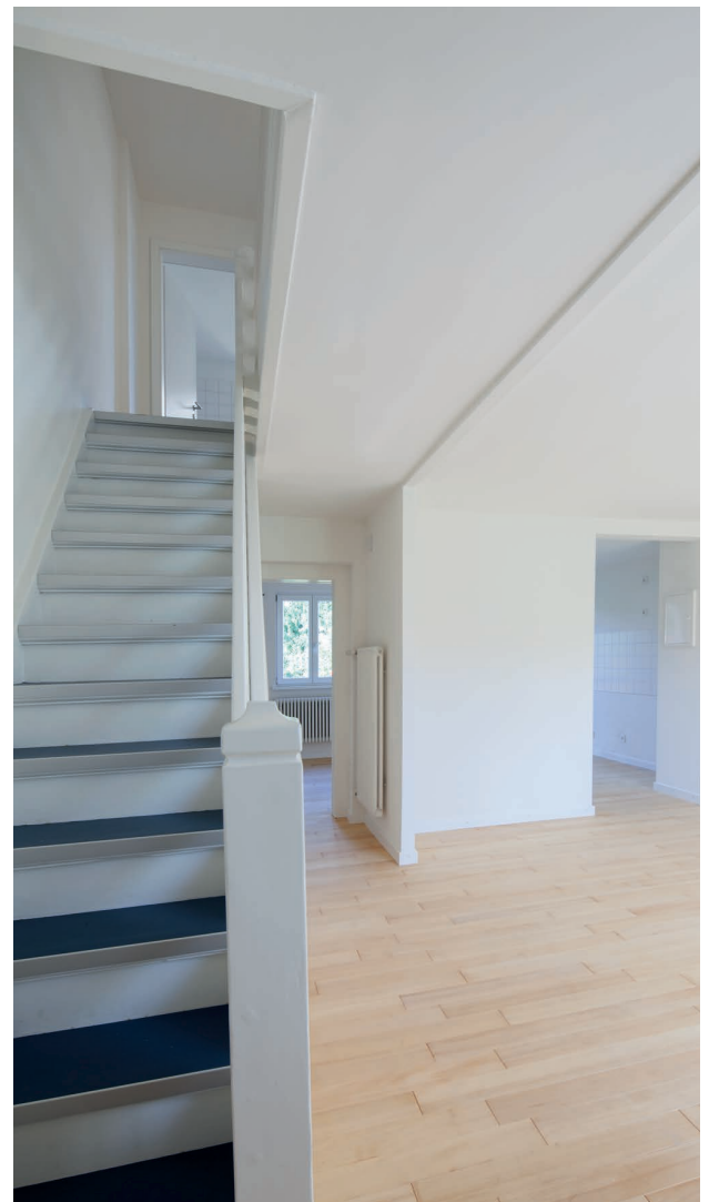
Blick in den offenen Wohnraum mit der Deckenmarkierung der ehemaligen Trennwand des Wohnraumes
