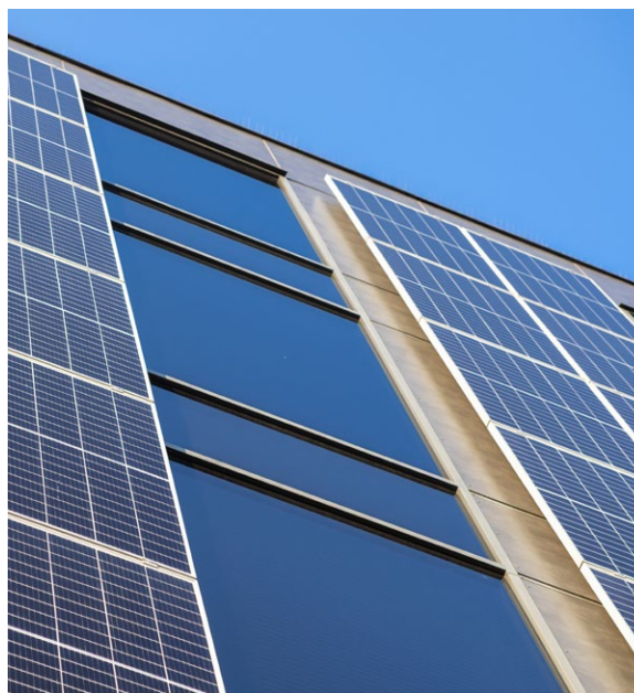
Abb. 3: Photovoltaikanlage an der Fassade
