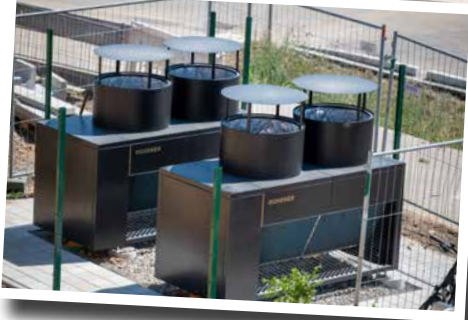
Blickfang im Osten: Bei den neuen Holzhäusern in Ebnet setzt die Stadtbau erstmals auf Wärmepumpen.
