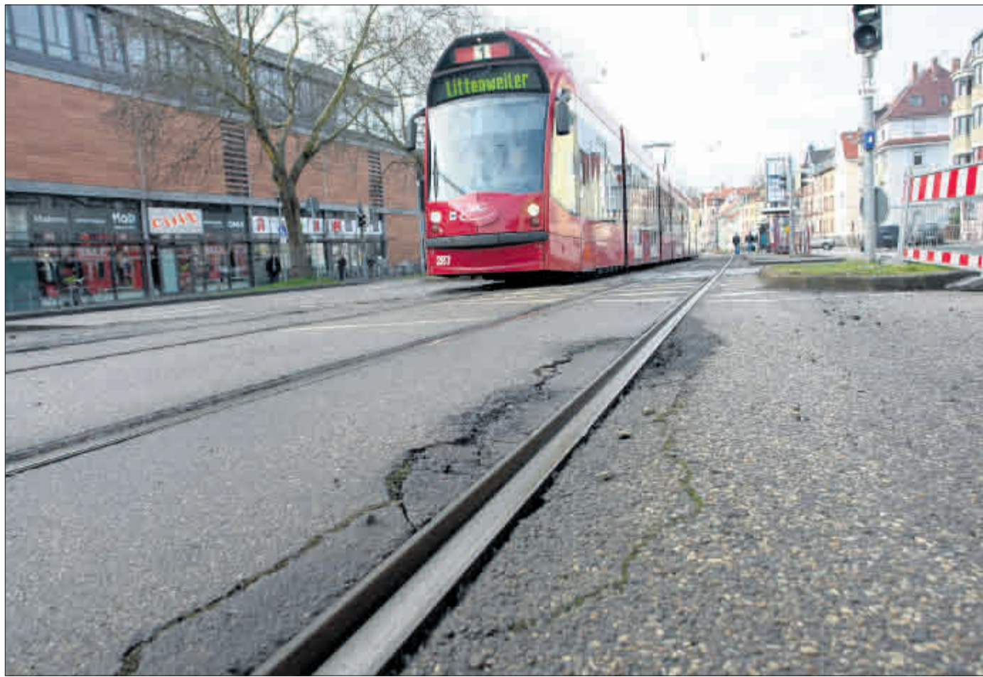
Die Schwarzwaldstraße – hier beim Zentrum Oberwiehre – wird in den kommenden zwei Jahren unter- und oberirdisch komplett erneuert. (Foto: R. Buhl)
