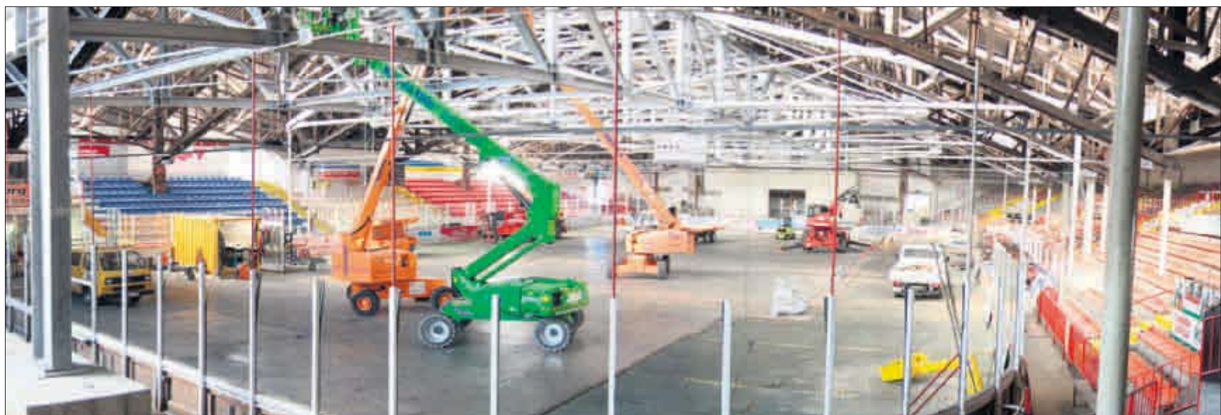
In der Eissporthalle stützt sich die filigrane Holzfachwerkkonstruktion des Daches jetzt auf eine massive Stahlkonstruktion. (Foto: A. J. Schmidt)
