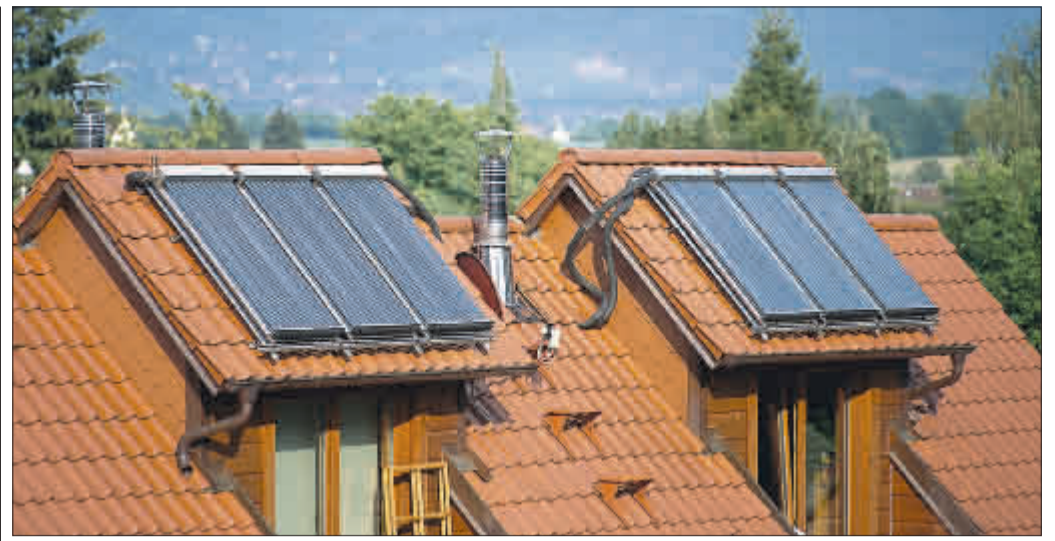
Kollektoranlage in Munzingen
